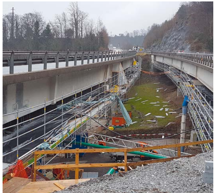
Das Sturmtief Burglind führte zu Schäden am Baustellengerüst und an Installationen. Die Autobahn A4 musste vorübergehend gesperrt werden.
